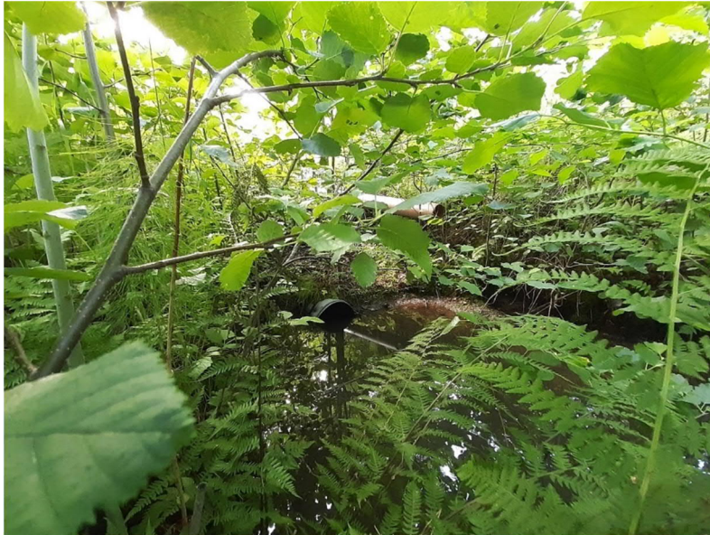
Kuva 4. Hulevesiputki Verkkolahden kosteikkoalueella.
