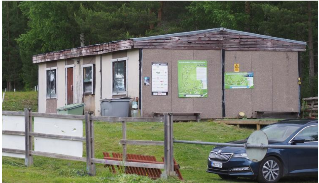
Kuva 6. Purkukunnossa oleva huoltorakennus.
