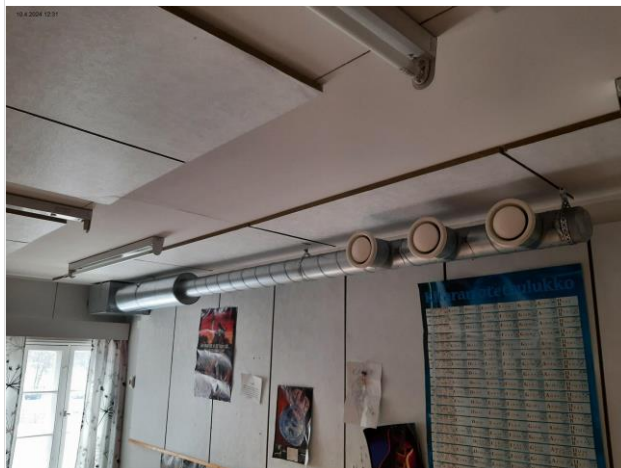
Kuva 126 Yhdessä luokkatilassa tehostettua poistoa
