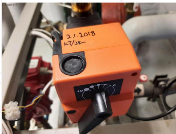
Kuva 114 Venttiilimoottoreita vaihdettu tarpeen mukaan
