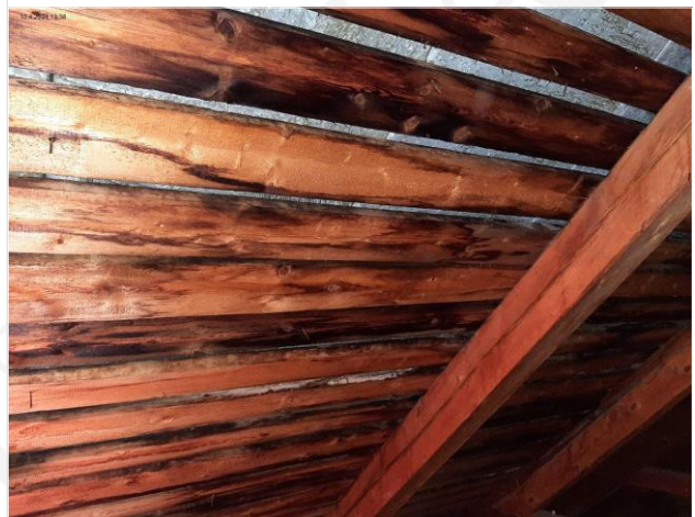
Kuva 40 Aluslaudoituksessa havaittiin vanhoja kosteusjälkiä
