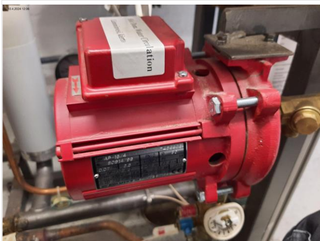
Kuva 113 Käyttöveden kiertovesipumppu piti voimakkaampaa ääntä
