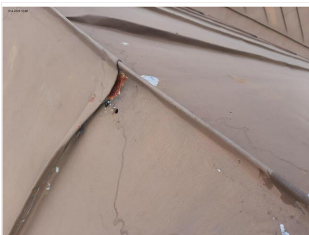
Kuva 67 Vesikatteessa havaittiin reikiä
