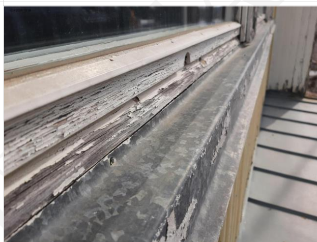
Kuva 56 Ikkunoiden vesipellitykset eivät olleet tiiviitä
