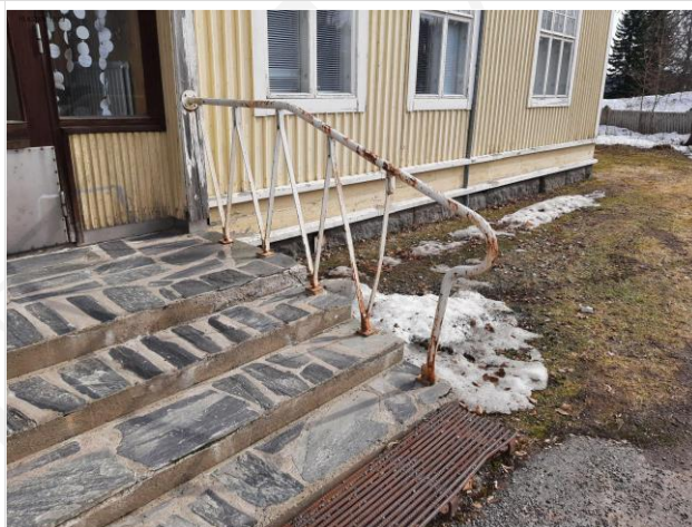
Kuva 8 Porraskaiteiden maalipinta kulunut / ruostunut
