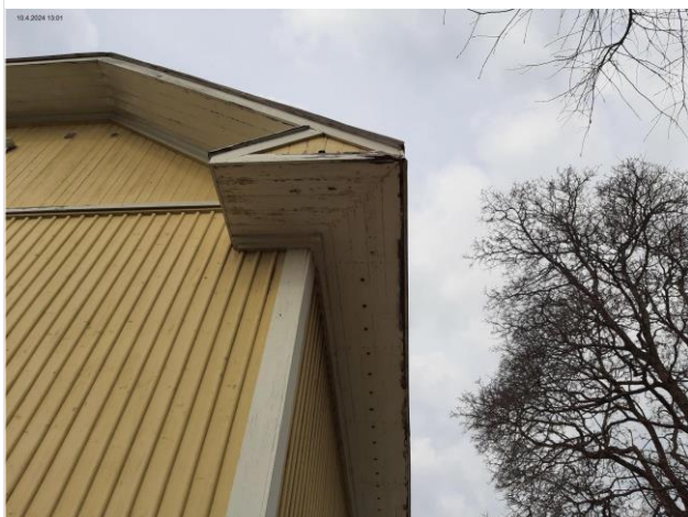
Kuva 61 Räystäässä havaittiin lahoa
