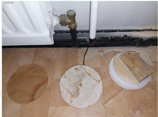
Kuva 28 Kosteusjälkiä seinärakenteiden sisässä
