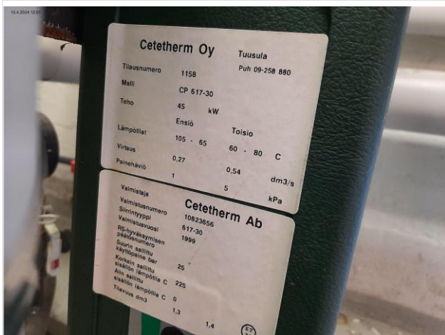
Kuva 106 Kaukolämmönvaihtimen tyyppikilpi pv
