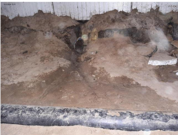
Kuva 19 Sade- / sulamisvedet valuivat ryömintätilaan
