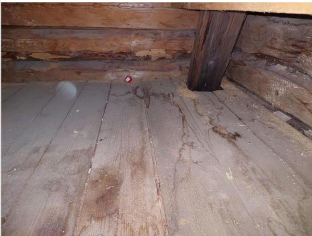
Kuva 31 Vuotojälki sivu-ullakolla alemman kerroksen ulkoseinässä vuotojälkien kohdalla
