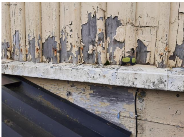
Kuva 47 Puuverhouksessa havaittiin paikoitellen lahoa
