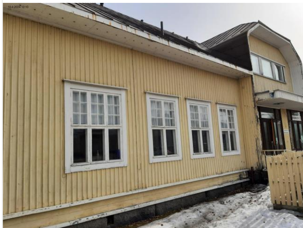
Kuva 10 Rakennuksessa ei ole sadevesijärjestelmää
