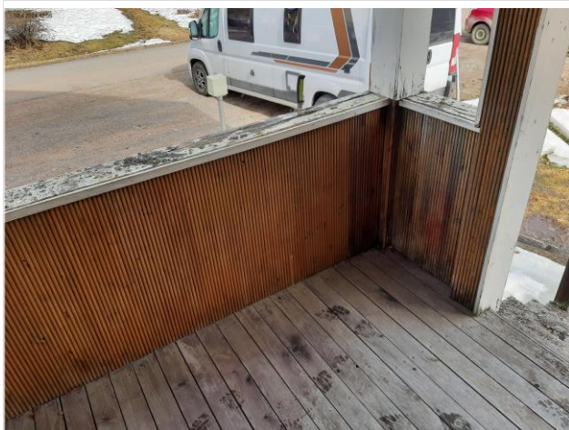
Kuva 7 Terrassin puurakenteissa lahovauriota ja huollon tarvetta
