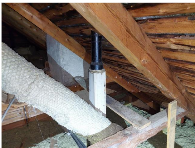
Kuva 45 Viemärin tuuletusputkea ei ollut lämpöeristetty
