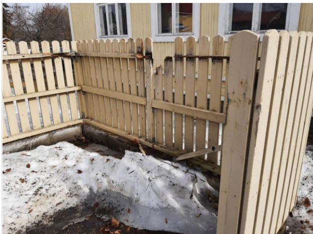
Kuva 5 Jätepisteen aita lahovaurioitunut
