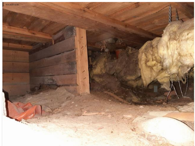
Kuva 20 Avonainen viemäriputken pää ryömintätilassa
