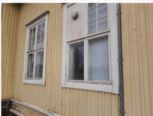
Kuva 55 Ikkunankarmien / -puitteiden maalipinnat hilseilivät
