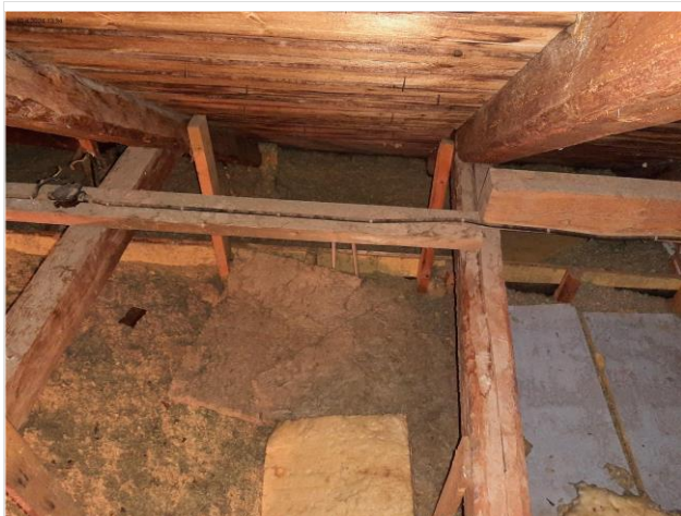
Kuva 43 Yläpohjan lämmöneristys oli osittain tukkinut räystäiden tuuletuksen
