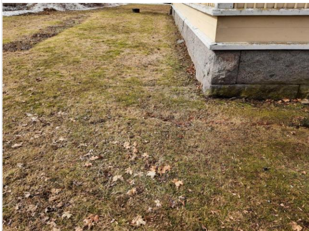
Kuva 9 Rakennuksen vierustalla maanpinta vietti paikoitellen rakennukseen päin
