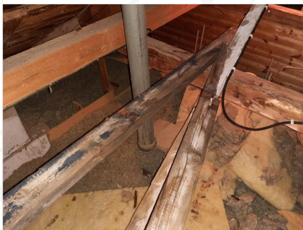
Kuva 46 Vanha viemärin tuuletusputki jätetty avonaisen yläpohjaan, eristeissä vuotojälkiä putken alla
