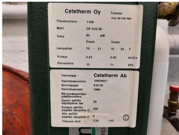
Kuva 105 Kaukolämmönvaihtimen tyyppikilpi lv
