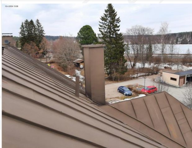
Kuva 76 Savupiipulta puuttui hattu
