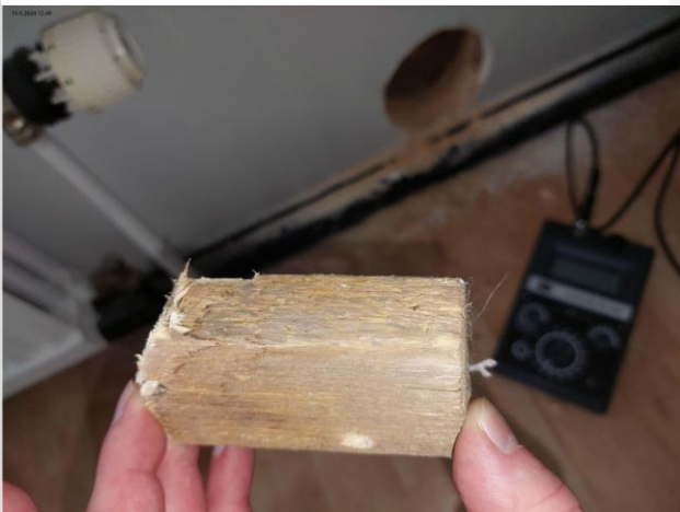
Kuva 29 Tummentumaa / kosteusjälkeä koolauspuussa
