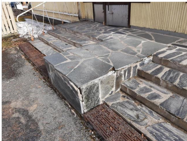
Kuva 6 Portaiden laatoitus irtoili
