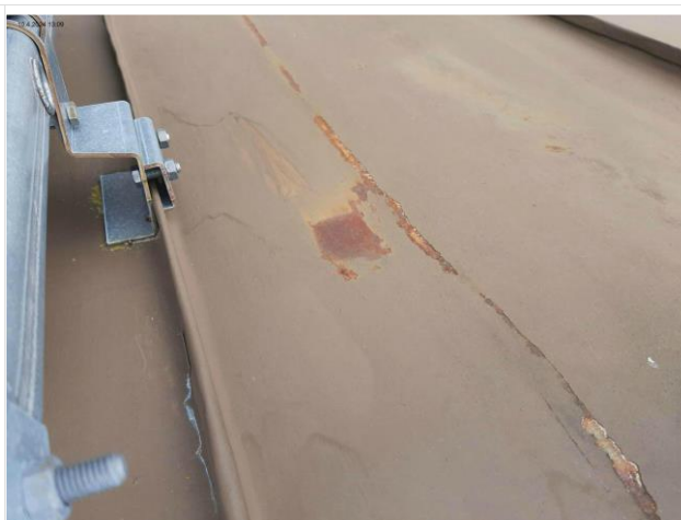
Kuva 68 Vesikate oli paikoitellen ruostunut
