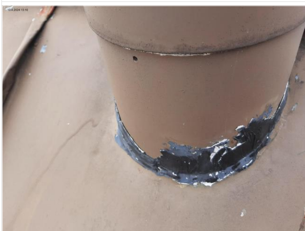
Kuva 69 Läpiviennin tiivistysauma rakoili
