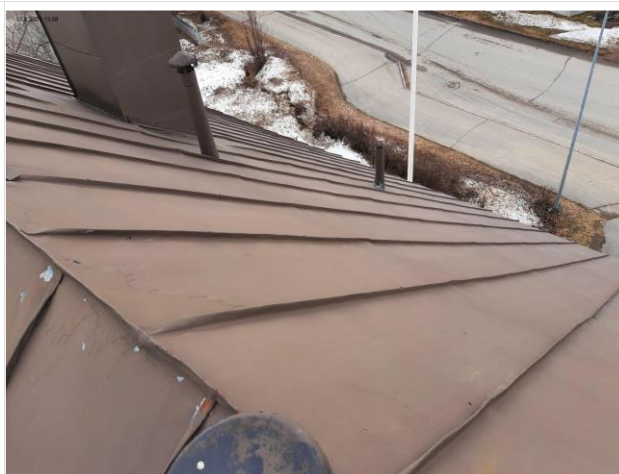
Kuva 74 Vesikatolla olevan läpiviennin yläpuolelta puuttui lumiä (läpiviennin etäisyys harjalta >1 m)
