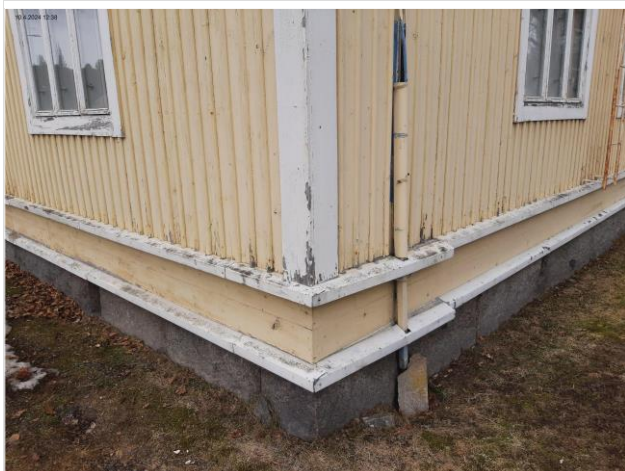
Kuva 49 Puuverhouksen maalipinta irtoili / oli kulunut
