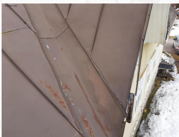
Kuva 70 Päätypeltien liitokset katteeseen olivat puutteelliset
