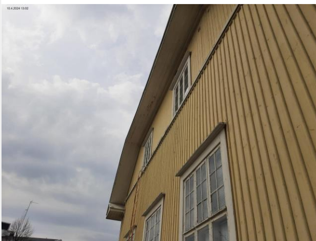
Kuva 62 Räystääslaudoitusten maalipinta irtoili
