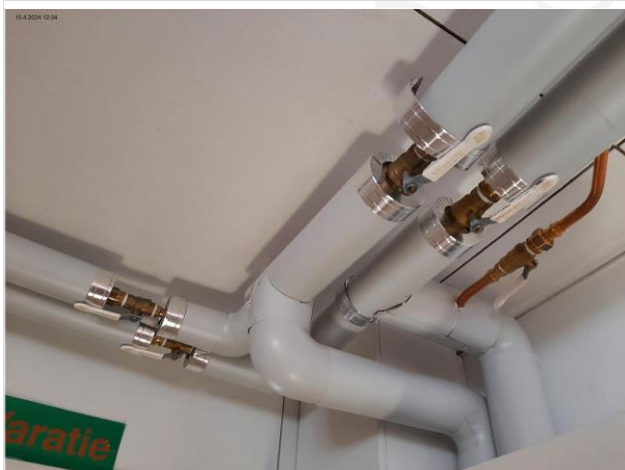
Kuva 115 Venttiilit silmämääräisesti kunnossa
