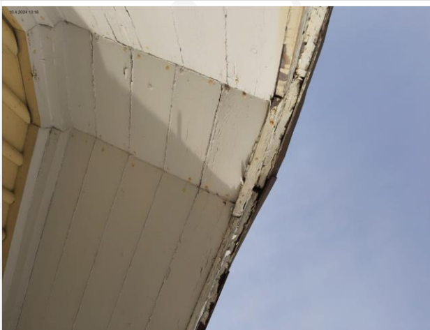
Kuva 64 Räystäässä havaittiin lahoa
