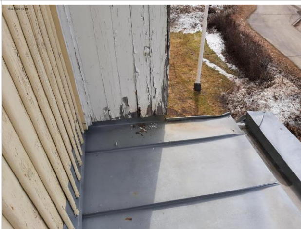
Kuva 52 Puuverhouksessa havaittiin paikoitellen lahoa
