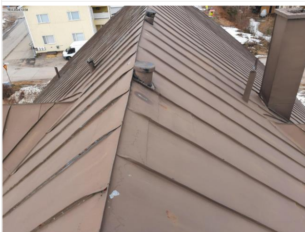
Kuva 75 Vesikatolla olevan läpiviennin yläpuolelta puuttui lumiä (läpiviennin etäisyys harjalta >1 m)
