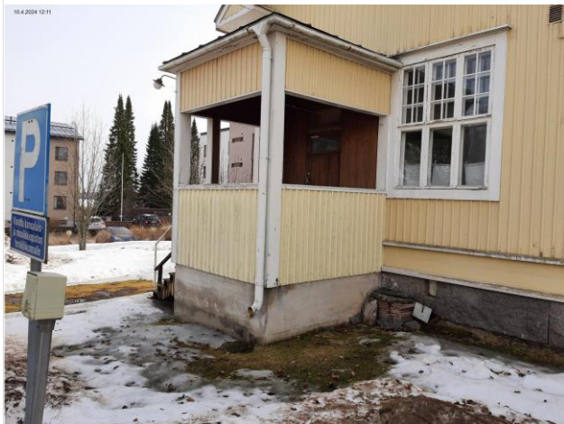
Kuva 11 Sadevedet ohjautuivat liian lähelle perustuksia
