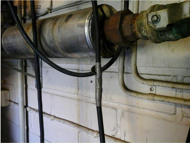
Kuva 76 Kiertovesipumpun sähköroikan kaapeli puutteellinen
