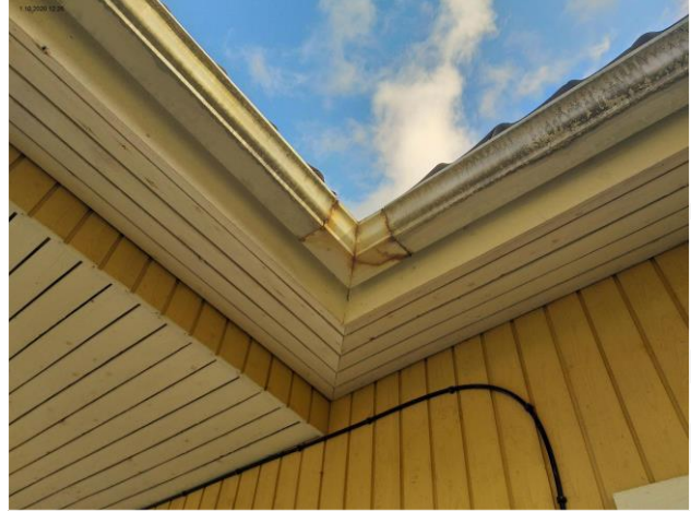
Kuva 27 Räystäskouruliitokset eivät olleet tiiviitä
