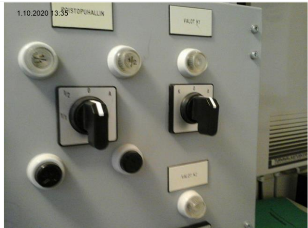
Kuva 87 Valaistuksen ohjauksen mekaaniset kytkimet
