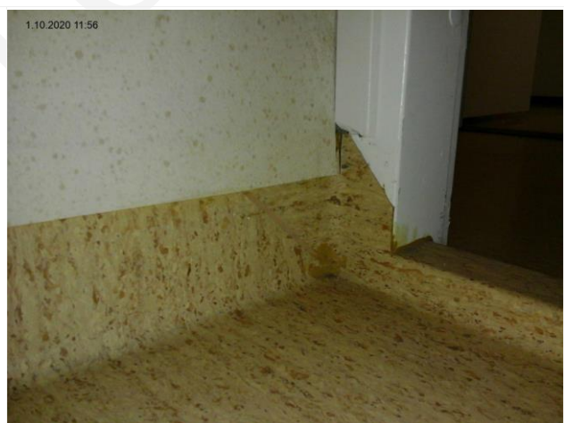
Kuva 46 Tiiveyspuute suihkutilan seinässä
