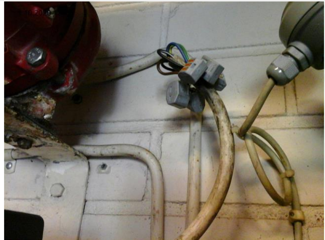
Kuva 75 Kiertovesipumppujen sähkökaapeleiden liitoksista puuttuu kytkinrasia
