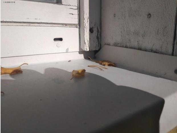
Kuva 21 Vesipeltien nurkat / reunat eivät olleet tiiviitä
