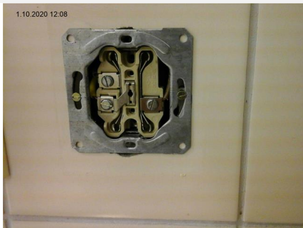
Kuva 79 Röntgenhuoneen pistorasia, suojamaalla
