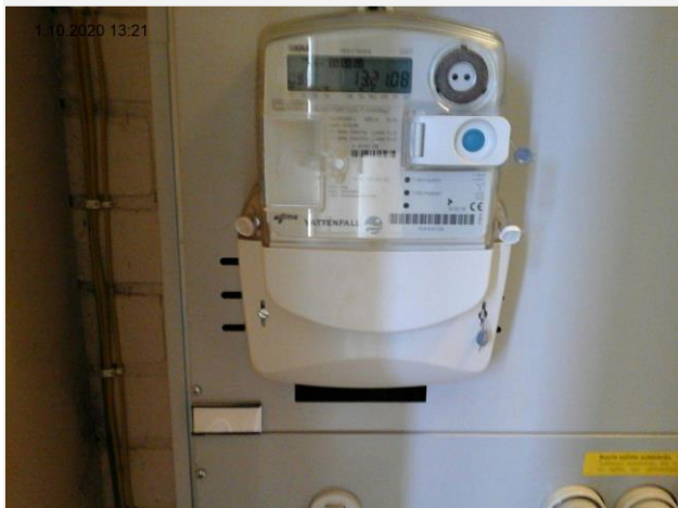
Kuva 92 Kiinteistön etäluettava sähkömittari
