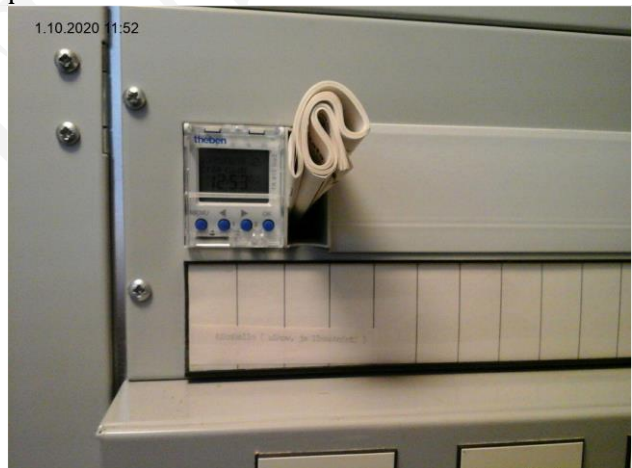
Kuva 85 Ulkovalaistusta ohjataan sähköpääkeskuksen kellokytkimellä ja hämäräkytkimellä
