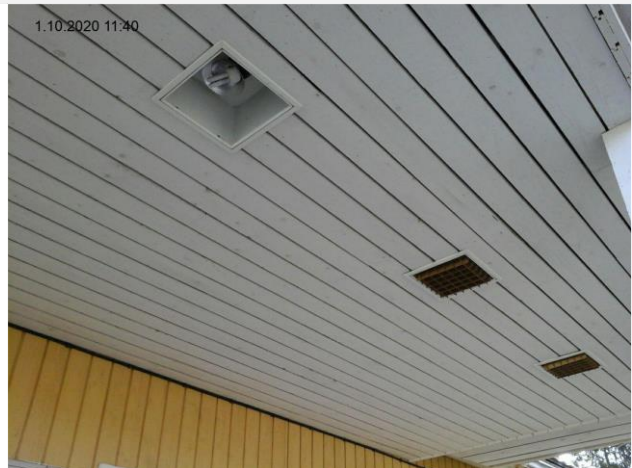
Kuva 83 Sisääntulovalaistus. Valaisimen ritilä puuttuu.
