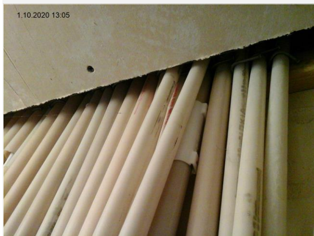
Kuva 64 SP:lta lähtevien nousukaapeleiden/suojaputkien läpivienti ei ole palotiivis
