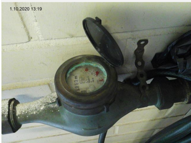
Kuva 91 Mekaaninen käyttövesimittari pannuhuoneessa
