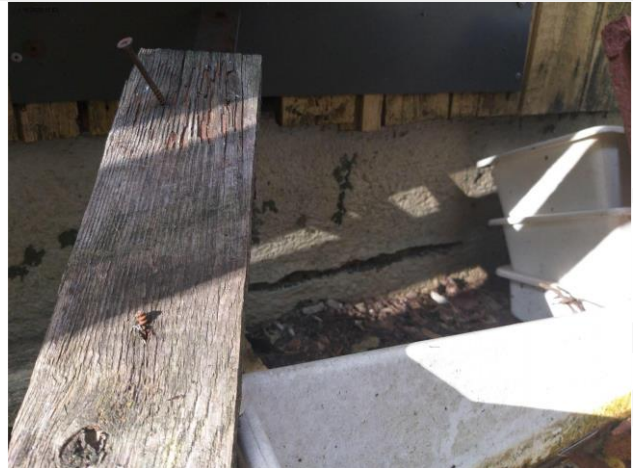
Kuva 9 Rakenteelliseen vaurioon viittaava halkeama perustuksissa
