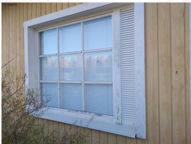
Kuva 19 Ikkunankarmien/-puitteiden maalipinnat hilseilivät
