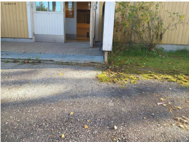
Kuva 12 Perustusten tasoero maanpintaan nähden ei ollut nykysuositusten mukainen
