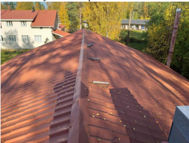
Kuva 28 Kulkusiltaja ei ollut
