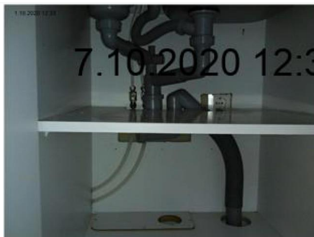
Kuva 54 Vesi- ja viemäriputkien liikkumista ei ollut estetty
