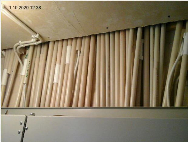
Kuva 68 Keskukselta 230V/400V sähkönsyöttö tiloihin
