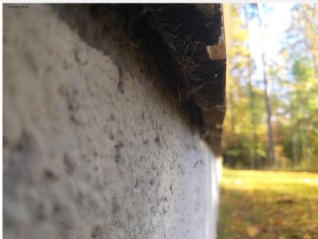
Kuva 17 Puuverhouksen taustalla oli riittävä tuuletusrako
