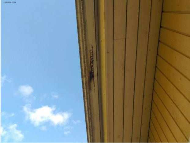
Kuva 26 Räystäskouru puhki ruostunut
