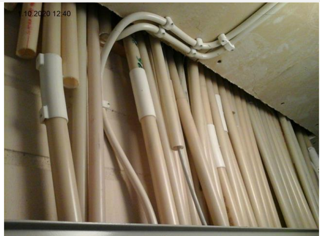
Kuva 67 Sähköpääkeskuksesta lähtevät nousukaapelit suojaputkissa
