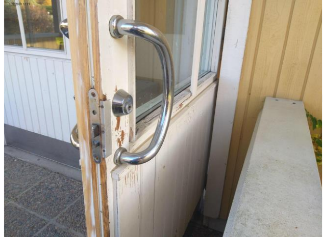
Kuva 22 Ulko-oven maalipinta irtoili
